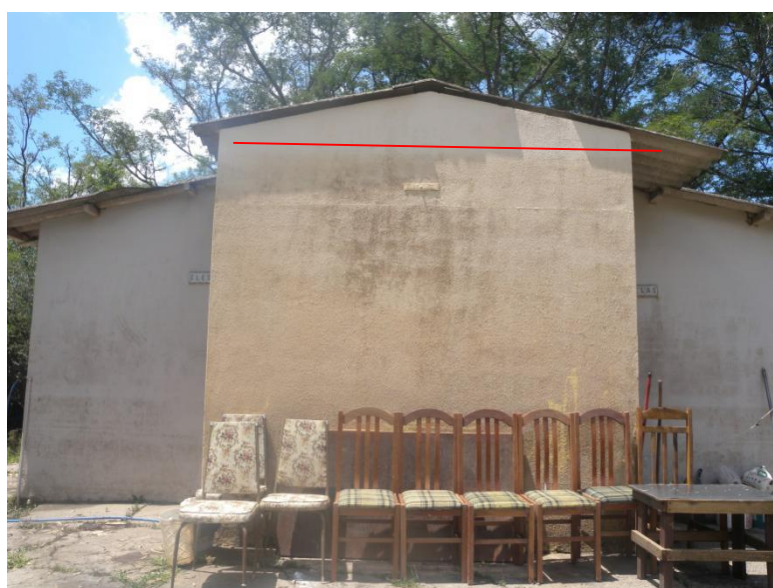
Figura 49 - Alcance de 2,30 metros da inundação no Bairro São João, em 2015.
