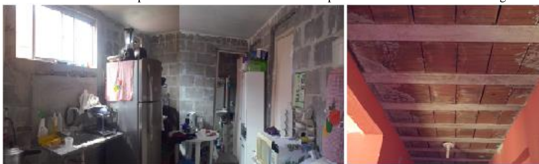
Figura 7 - À esquerda apartamento com estrutura inacabada entregue no Habitacional Via Mangue III e à direita teto sem reboco presente em todos os corredores dos prédios do Habitacional Via Mangue III.
