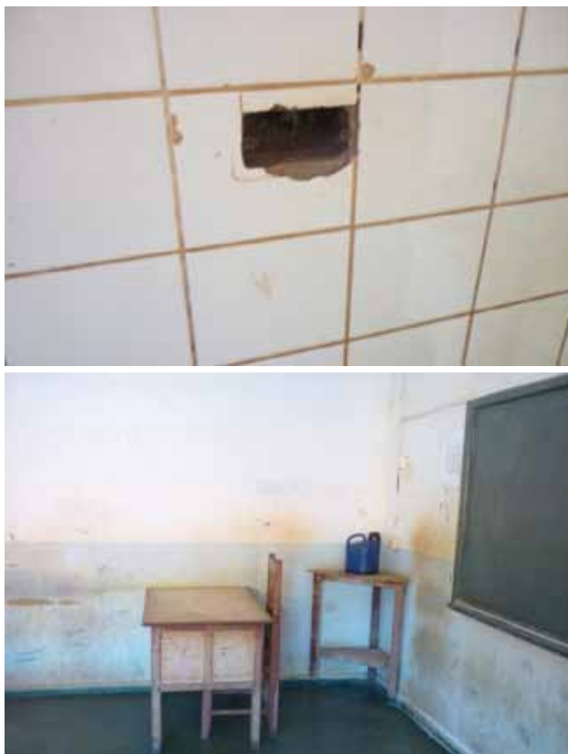
Figura 03: Condições físicas dos banheiros e salas de aulas Fonte: SILVA, Edson Batista da, 2011.
