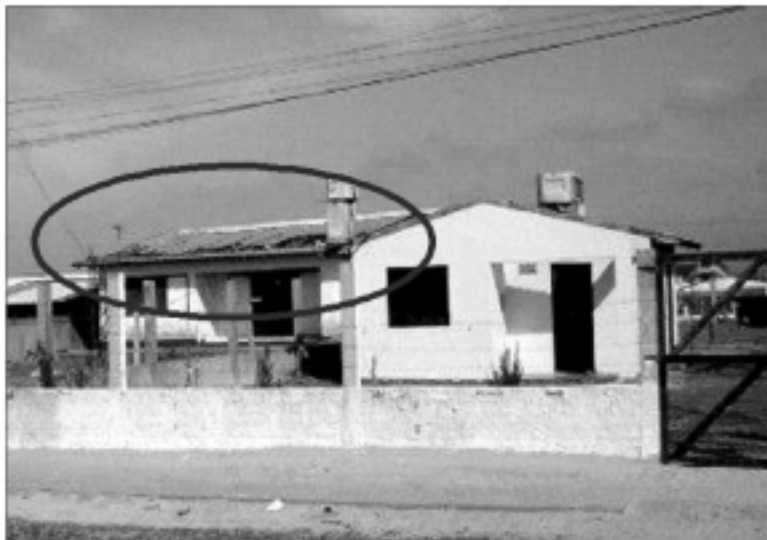
Figura 10 – Exemplo de residências danificadas relacionadas à forma dos telhados
