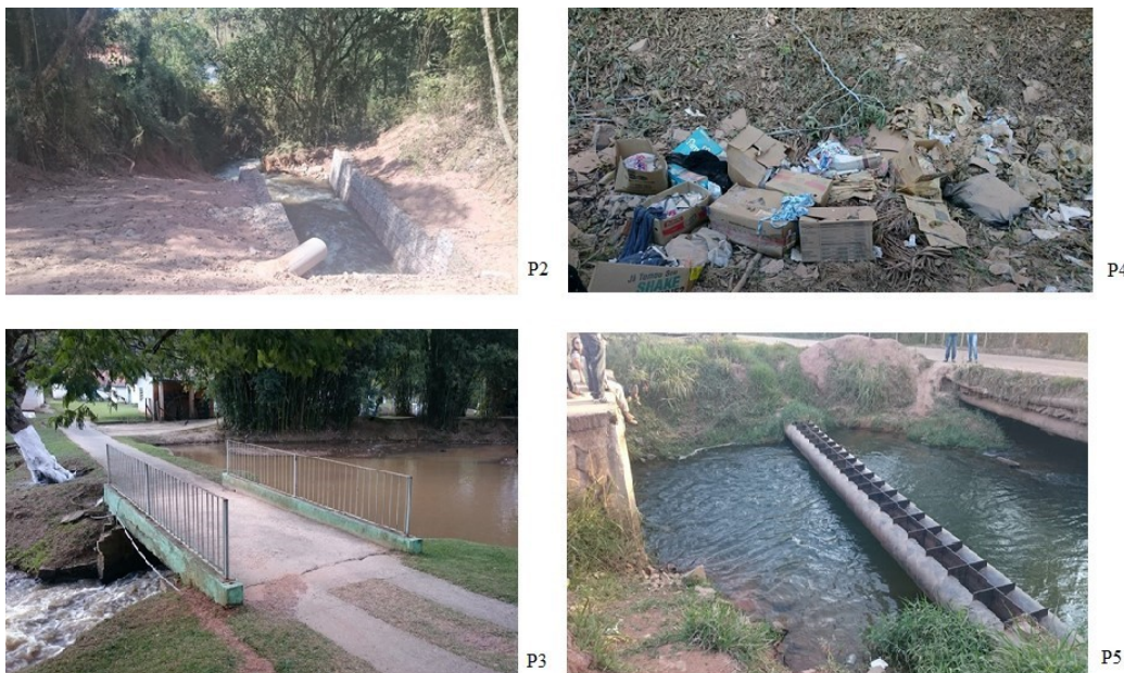
Figura 3. Registros fotográficos das visitas aos pontos de observação. Margens degradadas e vegetação exótica (P2), represamento e solapamento de margens (P3), descarte irregular de resíduos sólidos (P4) e acúmulo de sedimentos visíveis (P5).
