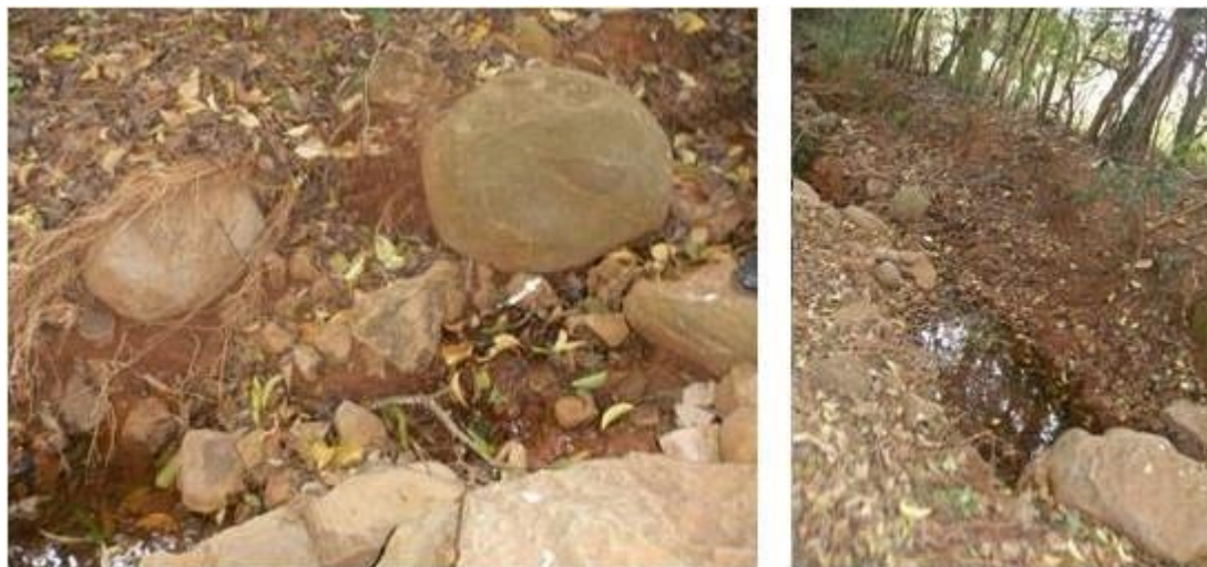
Figura 6 – Geofator A na nascente 3, com presença de erosão laminar (Foto A), erosão linear em forma de sulcos (Fotos B e D) e ravina (Foto C). Fonte: Google Earth®, 2013. Fotos: Arquivo pessoal.
