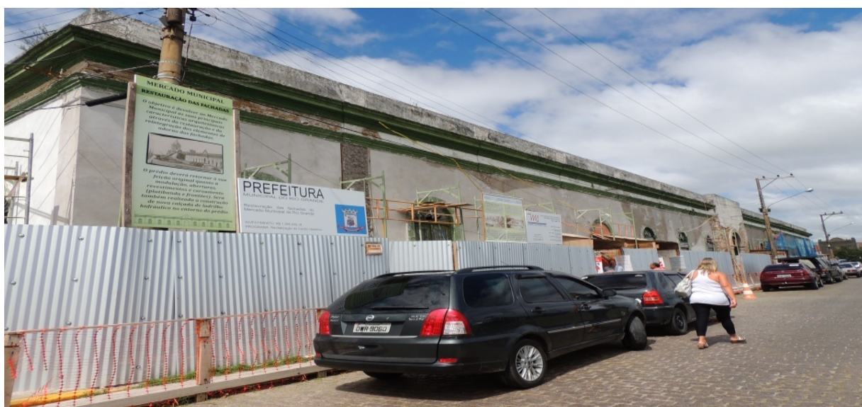
Figura 34. Registro da "restauração" da fachada externa
